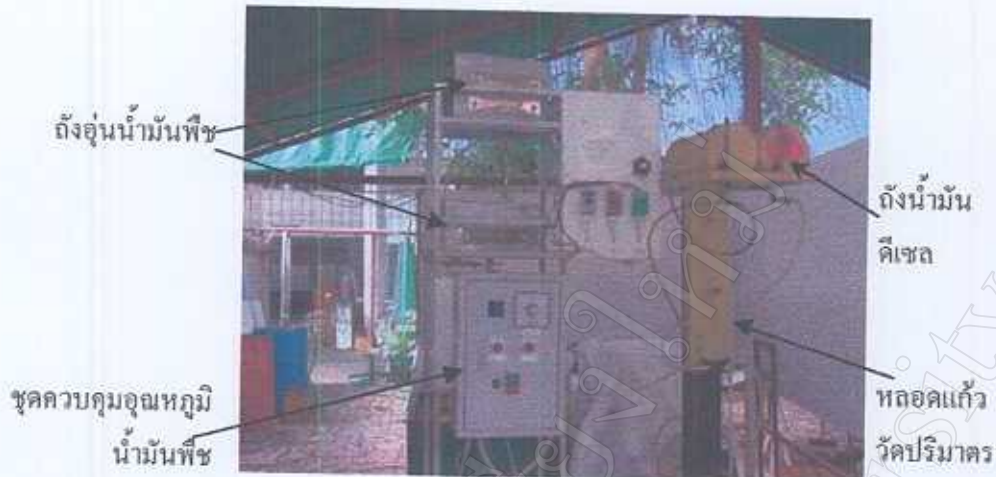
รูป 3.12 ถังน้ำมันดีเซลและชุดถังอุ่นน้ำมันพืช
