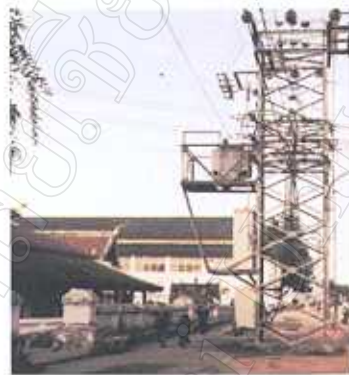
รูป 18 เสาไฟฟ้าแรงสูงบนทางเดินเท้าของถนนหน้าวัง
