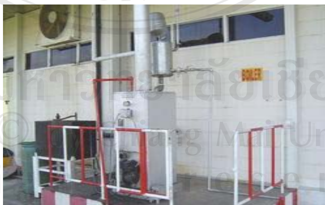
ภาพที่ 4.16 หม้อต้มน้ำที่ใช้น้ำมันดีเซลเป็นเชื้อเพลิง
