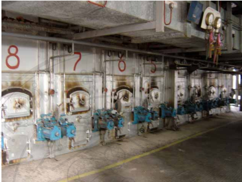
รูป 3.8 หม้อไอน้ำที่มีห้องเผาไหม้แบบสโตกเกอร์ขนาด 40 ตันไอน้ำ
