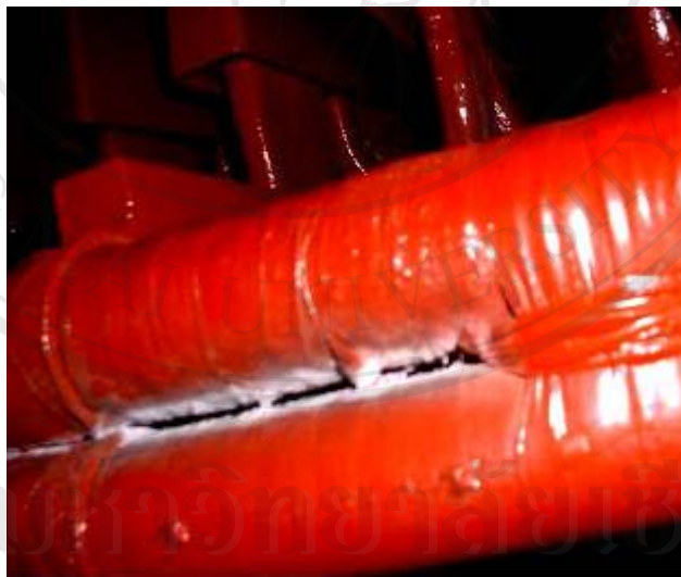
รูปที่ 4.29 การเกิดการปล่อยประจุบางส่วนของฉนวนเครื่องกำเนิดไฟฟ้าที่โรงไฟฟ้าพลังน้ำเขื่อนสิริกิติ์
