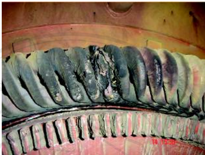
รูปที่ 4.31 การเกิดการปล่อยประจุบางส่วนของฉนวนเครื่องกำเนิดไฟฟ้าเกิดภาวะสุดกำลัง
