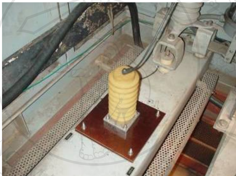
รูปที่ 5.20 ตัววัดการปล่อยประจุบางส่วนชนิดอีพ็อกซี่-ไมก้าขนาด 80 พิโคฟาราดที่ติดตั้ง ที่โรงไฟฟ้าราชนรี
