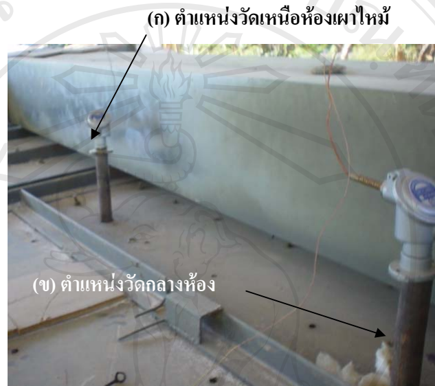
รูปที่ 3.11 ตำแหน่งบริเวณเพดานเหนือห้องเผา (ก) บริเวณเหนือห้องเผาไหม้วัดอุณหภูมิไฟที่ใช้ในการเผาไหม้, (ข) บริเวณเหนือห้องเผาไหม้วัดอุณหภูมิใช้ควบคุมการเผาไหม้ด้านบน
