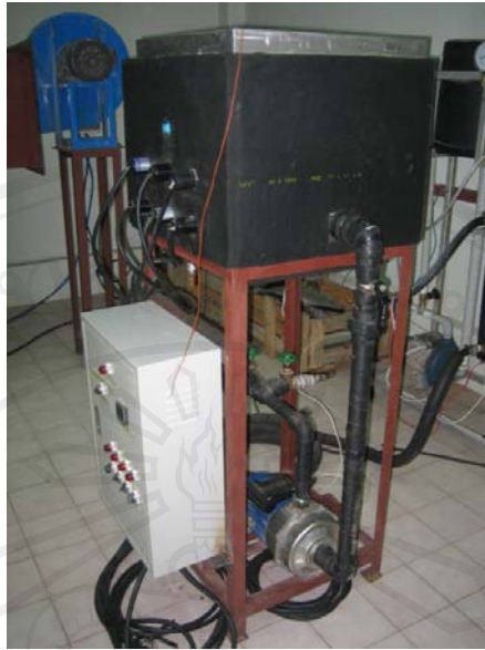
รูปที่ 3.3 ภาพถ่ายระบบให้ความร้อน
