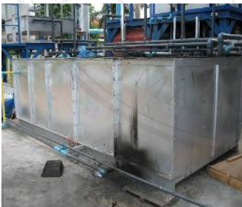
จ. ระบบบำบัดน้ำเสีย (Close System)
