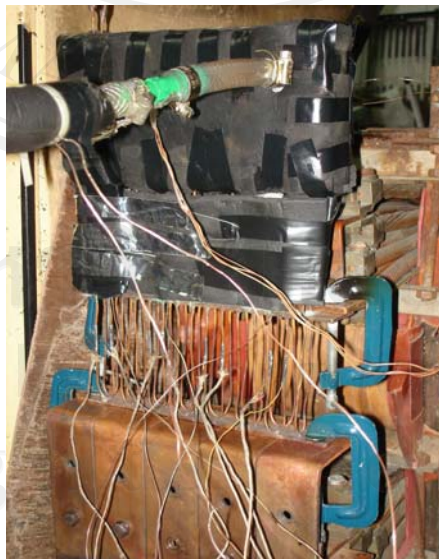
รูปที่ 3.17 การติดตั้งท่อความร้อนเข้ากับชุดเครื่องแปลงไฟฟ้า ติดตั้งสายเทอร์โมคัปเปิล และสายยาง
