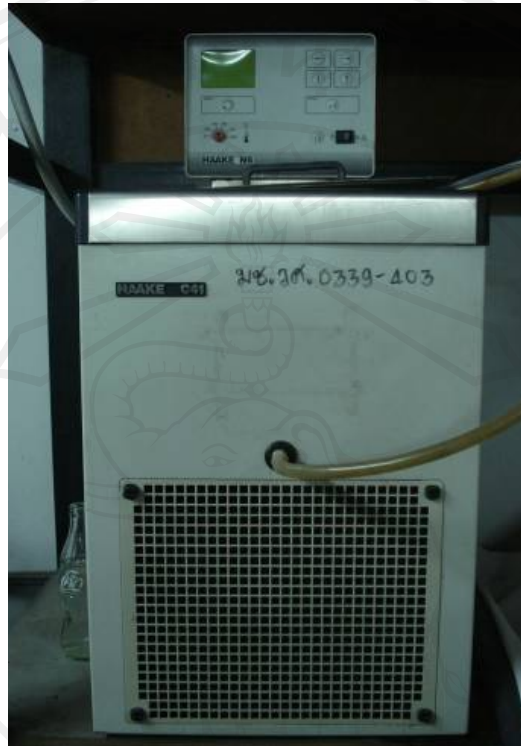
รูปที่ 3.3 เครื่องทำเย็นน้ำหล่อเย็น
