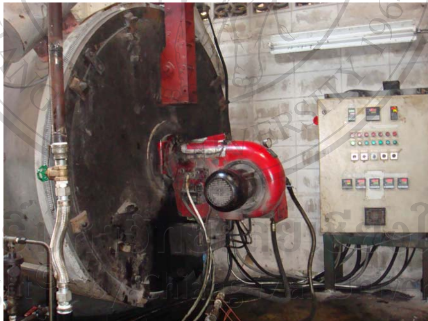
ภาพ 4.5 หม้อต้มน้ำมันร้อน (Hotoil Boiler)
