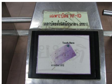
ภาพที่ 4.4 แสดงบริเวณประตูทางเข้าที่ใช้ระบบอาร์เอฟไอดี
