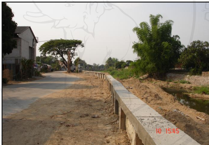
รูปที่ 3.12 แสดงอาคารป้องกันตลิ่งแม่น้ำทาในเขตเทศบาลตำบลป่าซาง ในปัจจุบัน
