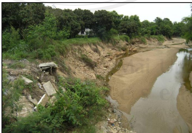
รูปที่ 3.13 แสดงสภาพการกัดเซาะตลิ่งแม่น้ำทาในเขตเทศบาลตำบลป่าซาง
