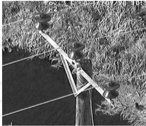
รูป 1-4 เสาไฟฟ้าในระบบจำหน่าย
