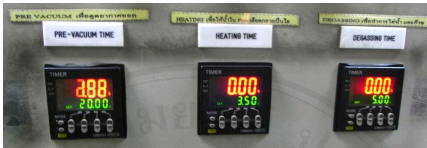
รูปที่ 3.18 เครื่องตั้งเวลา (Timer) ควบคุมการทำงานแต่ละช่วงของเครื่องควบคุม ปริมาณสารทำงานและสถานะสุญญากาศ
