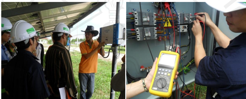
รูปที่ ภผ ข.1 โรงไฟฟ้าพลังงานแสงอาทิตย์ บริษัท อินฟินิต กรีน จำกัด
