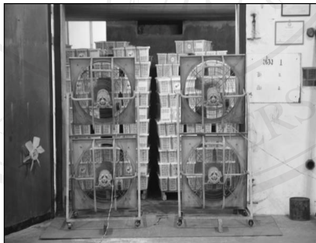
ภาพ 14 การใช้พัดลมช่วยในการระบาย และลดปริมาณก๊าซซัลเฟอร์ไดออกไซด์ในห้องรม
