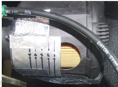
รูปที่ น.3 ลักษณะชุดกรองที่ติดตั้งอยู่กับเครื่องอัดอากาศ
