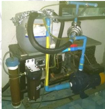
ภาพที่ 3.11 แสดงระบบทำน้ำหล่อเย็น
