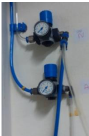
ภาพที่ 3.6 แสดงหัวจ่ายก๊าซ และท่อส่งก๊าซ
