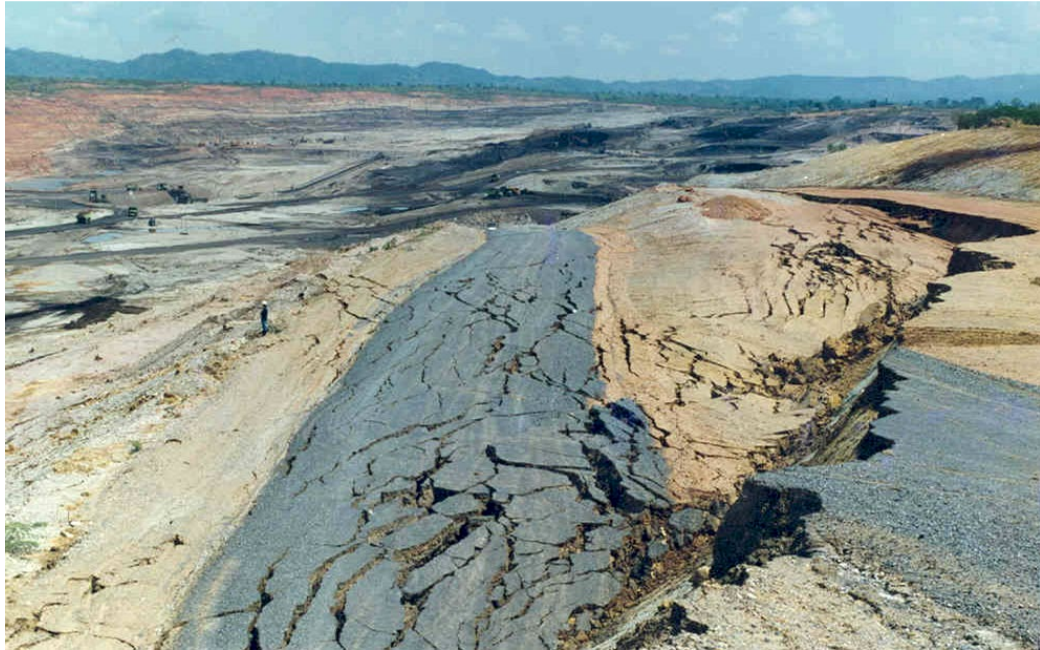
รูปที่ 2.13 กรณีถนน C พังทลายใน Mode 4 (กองวิศวกรรมธรณี เหมือนแม่เกาะ, 2533)
