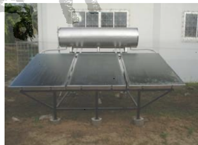
ภาพที่ ก8 แผง Solar collector
