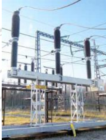
ภาพที่ 2.13 เซอร์กิตเบรกเกอร์แบบฉนวนอากาศ
